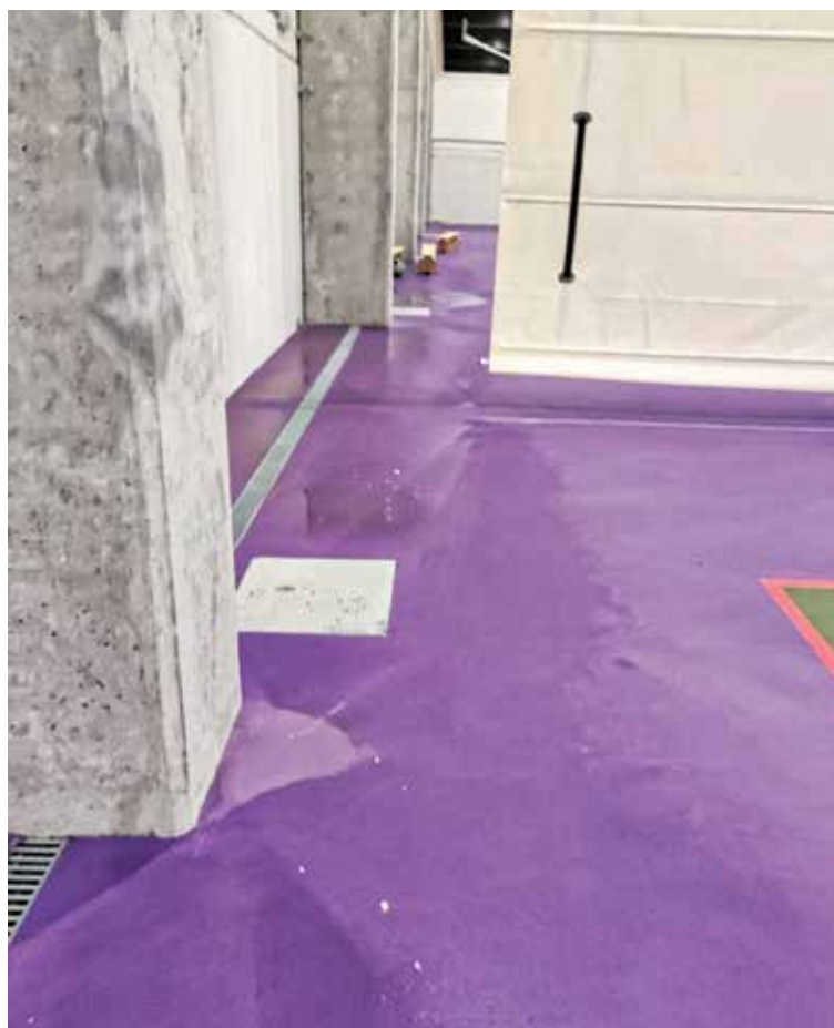
▲ Estado de uno de los espacios del pabellón, después de uno de los episodios de lluvia AV PAU ENSANCHE VALLECAS
