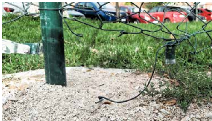
▲ El peligroso estado de una parte del cerramiento
