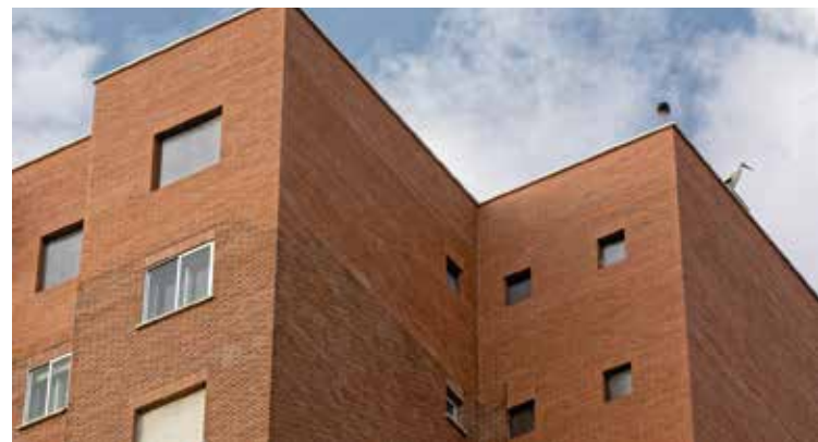
El edificio más afectado por la deflagración.
